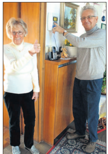
Nachträglich eingebaut: Ilse und Walter Neumann aus Gudensberg fühlen sich sicher, dank des Sicherungs- und Regelsystems der EFP GmbH.
